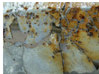
Figura 1: Corrosión bajo tensiones en un depósito de agua caliente en AISI 304L
