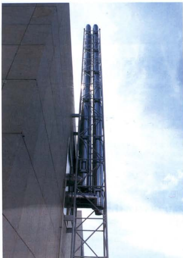
Central Térmica, hospital de CEE
