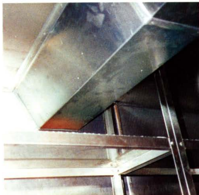
• Aislamiento de buque frigorífico
