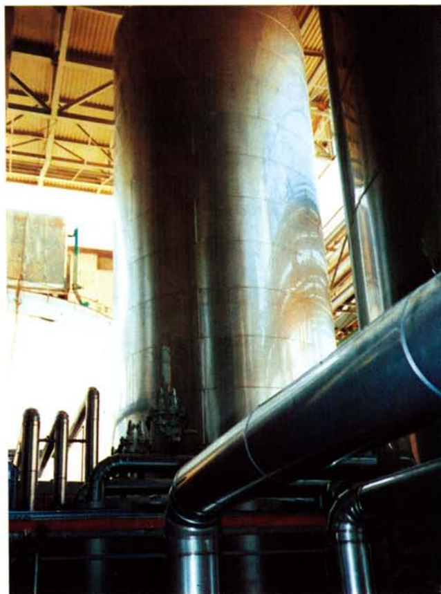
• Aislamientos de tuberías
