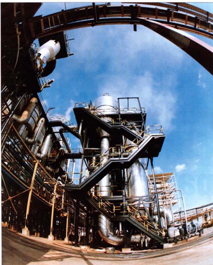
Planta de evaporación-concentración de la Empresa Nacional de Celulosas de Huelva.
