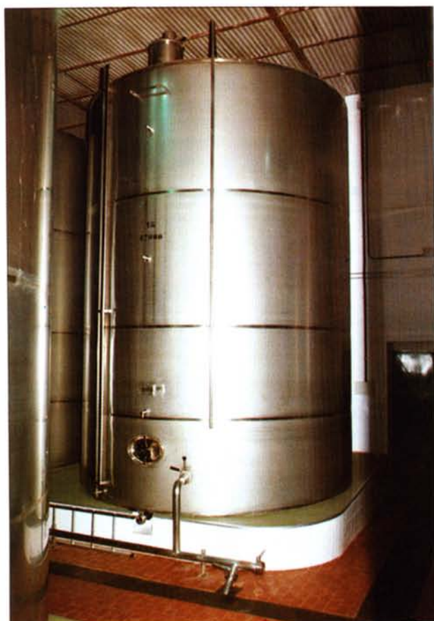
Depósitos en AISI 304 con capacidad para 50.000 kilos.
