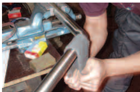
Ruční dokončení spojů kompletního zábradlí jednou dokončovacím operací tvořící hladký spoj mezi dvěma trubkami.
