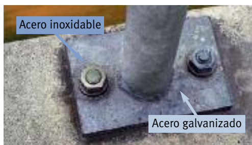
Figura 8a, 8b: Las sujeciones de acero inoxidable en componentes mucho mayores de acero galvanizado, normalmente, no provocan corrosión
