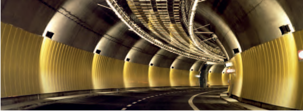
Die Wandbekleidung dieser Tunnelröhre muss hohen Korrosionsbelastungen widerstehen und soll gleichzeitig Blendwirkungen vermeiden. Foto: ThyssenKrupp Acciai Speciali Terni, Terni (I)
