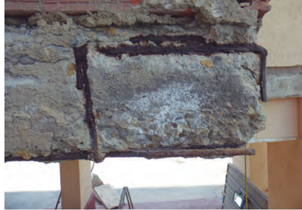
Figura 4: Frente de forjado afectado por oxidación
