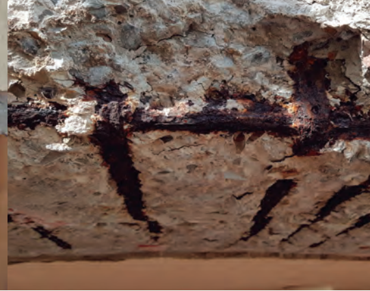
Figura 5: Fisuras en cara inferior de frente forjado
