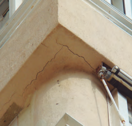
Figura 1: Fisuras en cara inferior de frente forjado
