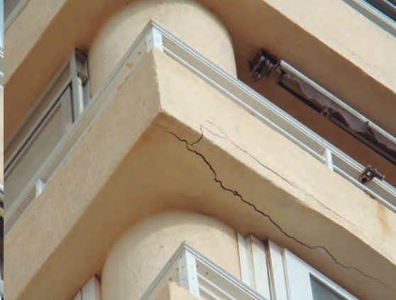
Figura 2: Fisuras en cara inferior de frente forjado
