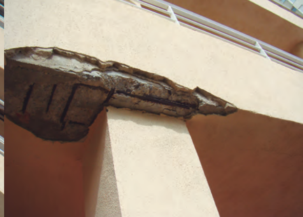
Figura 3: Detalle de desprendimientos
